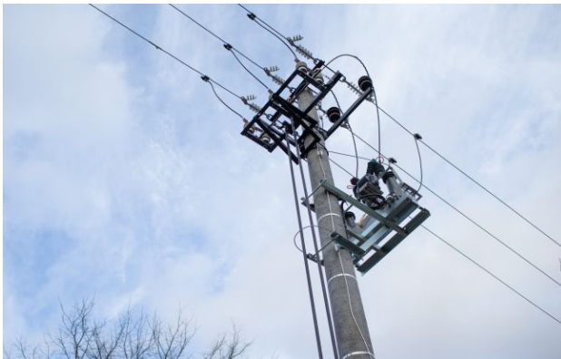
ДТЕК відновлює електропостачання після атак РФ (фото: dtek.com)
