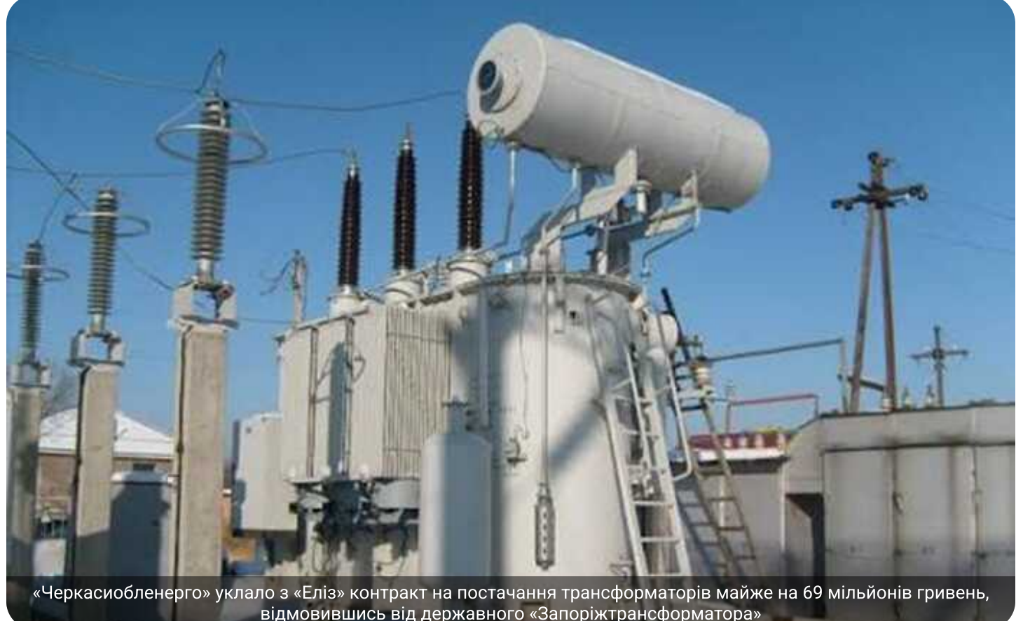
АТ «Черкасиобленерго» уклало з «Еліз» контракт на постачання трансформаторів майже на 69 мільйонів гривень, відмовившись від державного «Запоріжтрансформатора»
