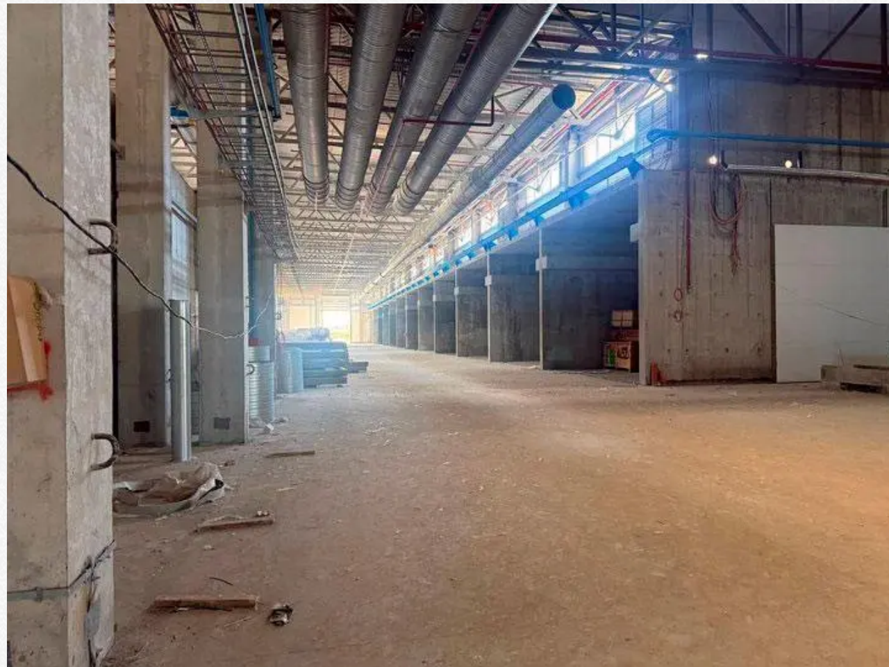
Сміттєпереробний завод всередині (25.07.2026 р.). Фото: Суспільне Львів/Ольга Дейнека
