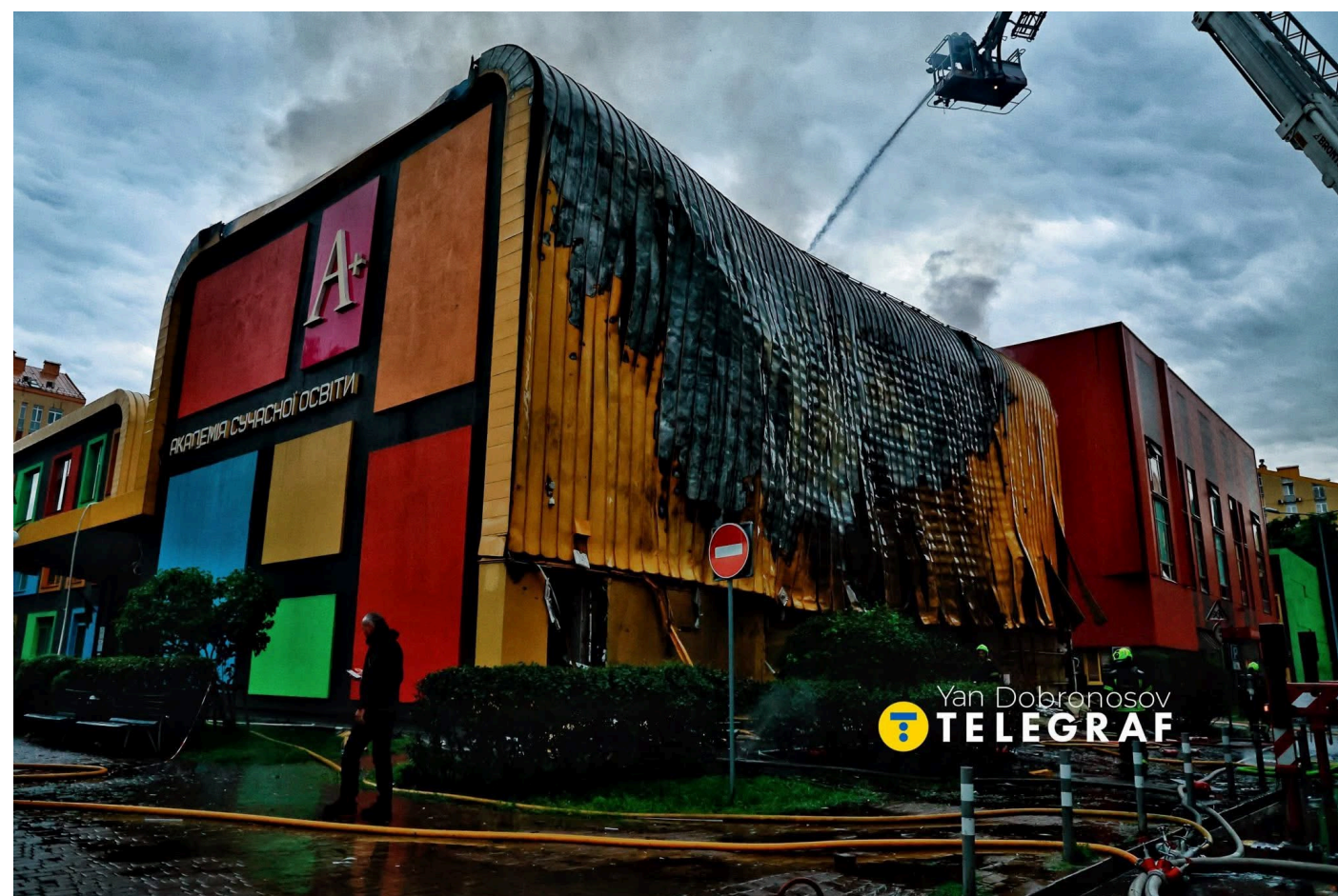
Навчальний заклад «Академія-А», пошкоджений під час нічної атаки 15 червня 2026 року фото: telegraf.com.ua
