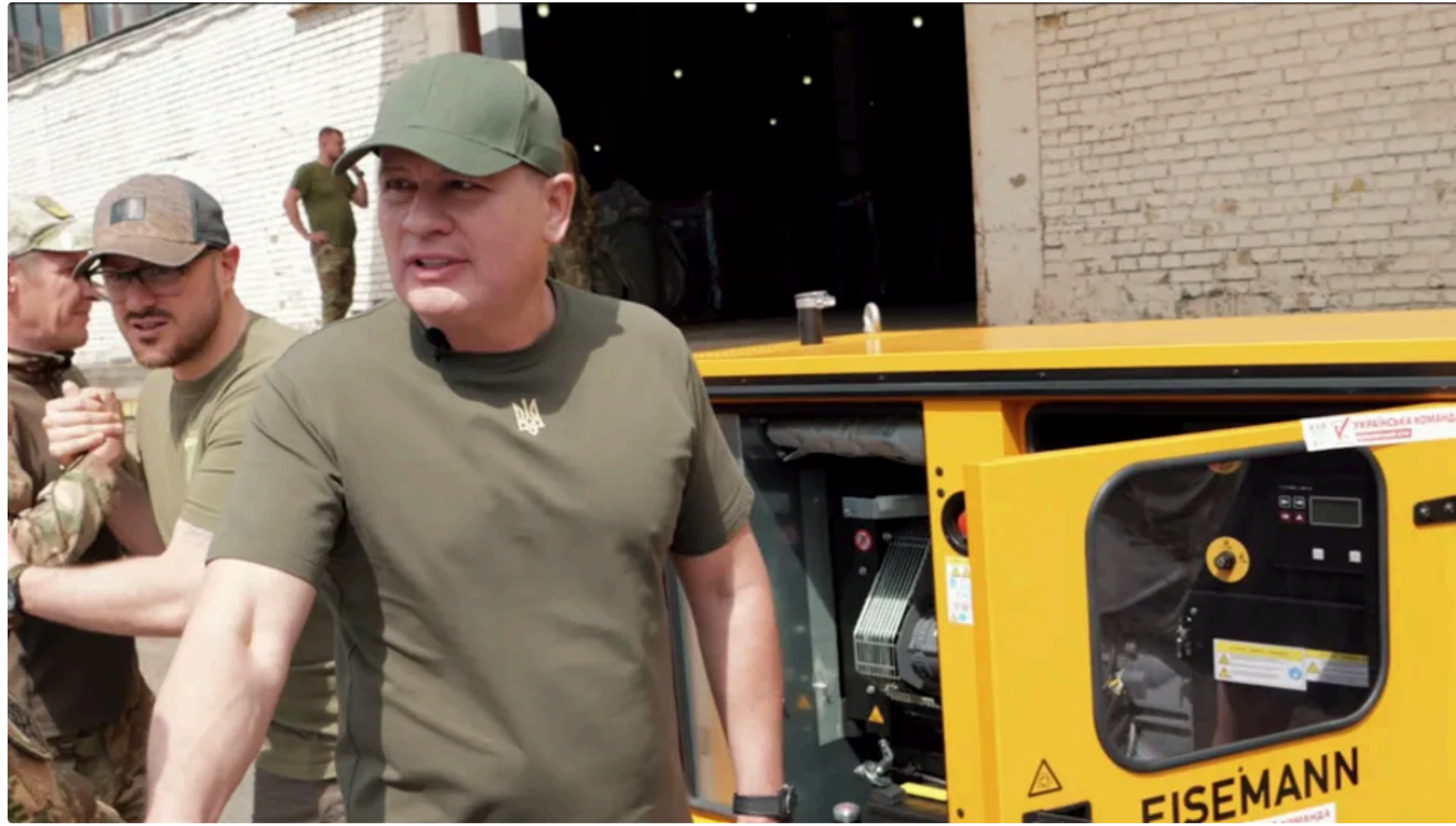
Генератор потужністю 16 кВт здатен забезпечити електрикою шпиталь чи майстерню Фото: Волонтерський штаб "Українська команда" / Facebook
