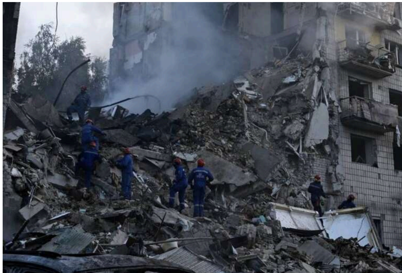
У Києві понад 40 поранених внаслідок масованої атаки РФ: триває розбір завалів у зруйнованому будинку
