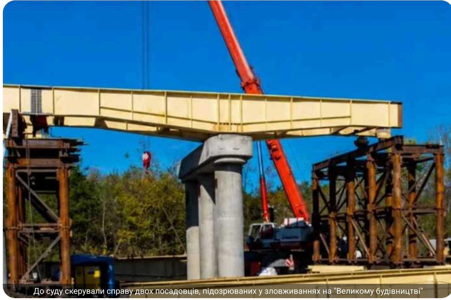
До суду скерували справу двох посадовців, підозрюваних у зловживаннях на "Великому будівництві"
