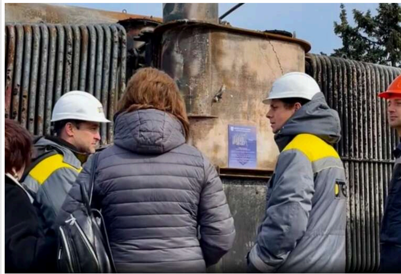
ДТЕК продемонстрував зруйнований росіянами трансформатор в Одеській області
