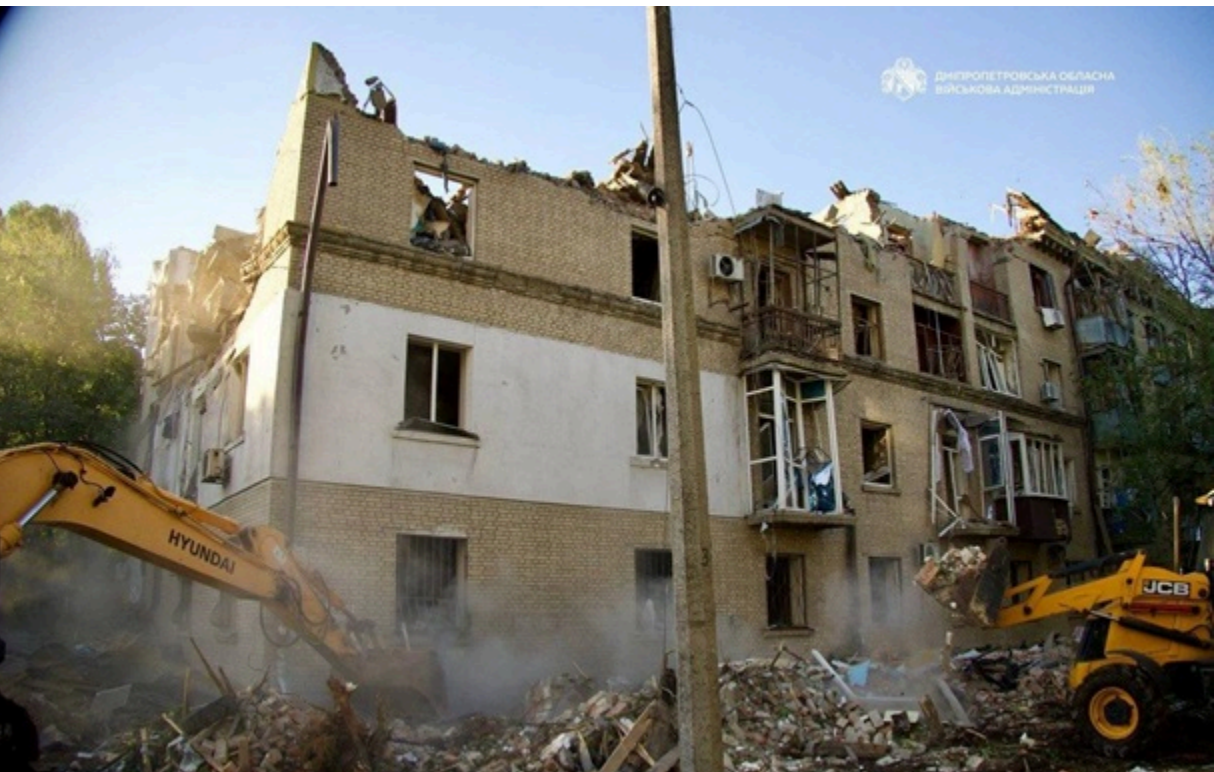
Фото: Дніпропетровська ОДА (ОВА) Зруйнований будинок у Дніпрі після атаки рашистів
