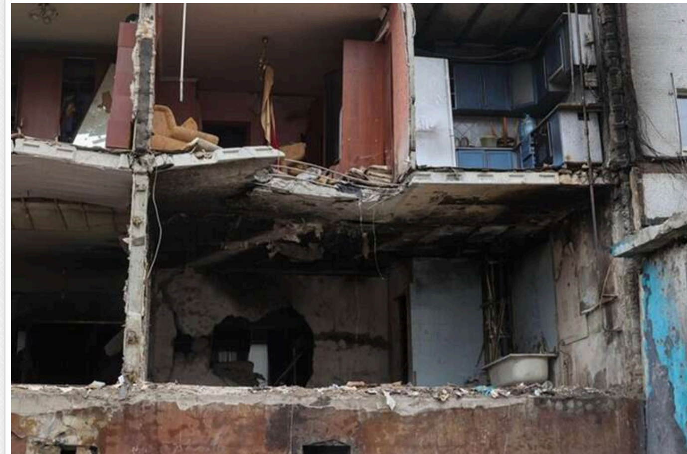
У Харкові завершили аварійно-відновлювальні роботи після удару БПЛА
