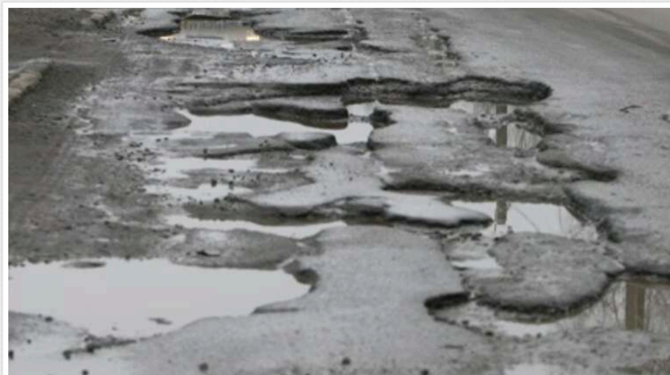
У Чернівцях ТОВ отримало підряд на ремонт вулиці на 32 мільйони грн без конкуренції, і зі ймовірною переплатою понад 1 мільйон
