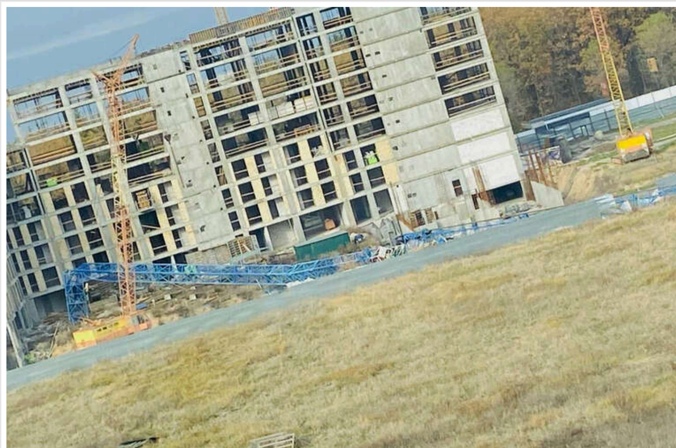
Під Києвом обвалився будівельний кран, - поліція
