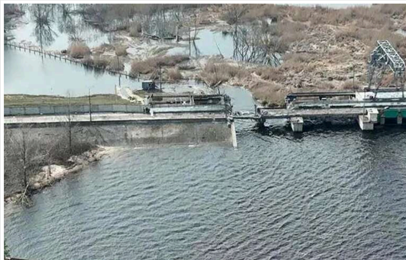
Унаслідок пошкодження окупантами греблі з Курахівського водосховища вилитося 15 мільйонів кубометрів води
