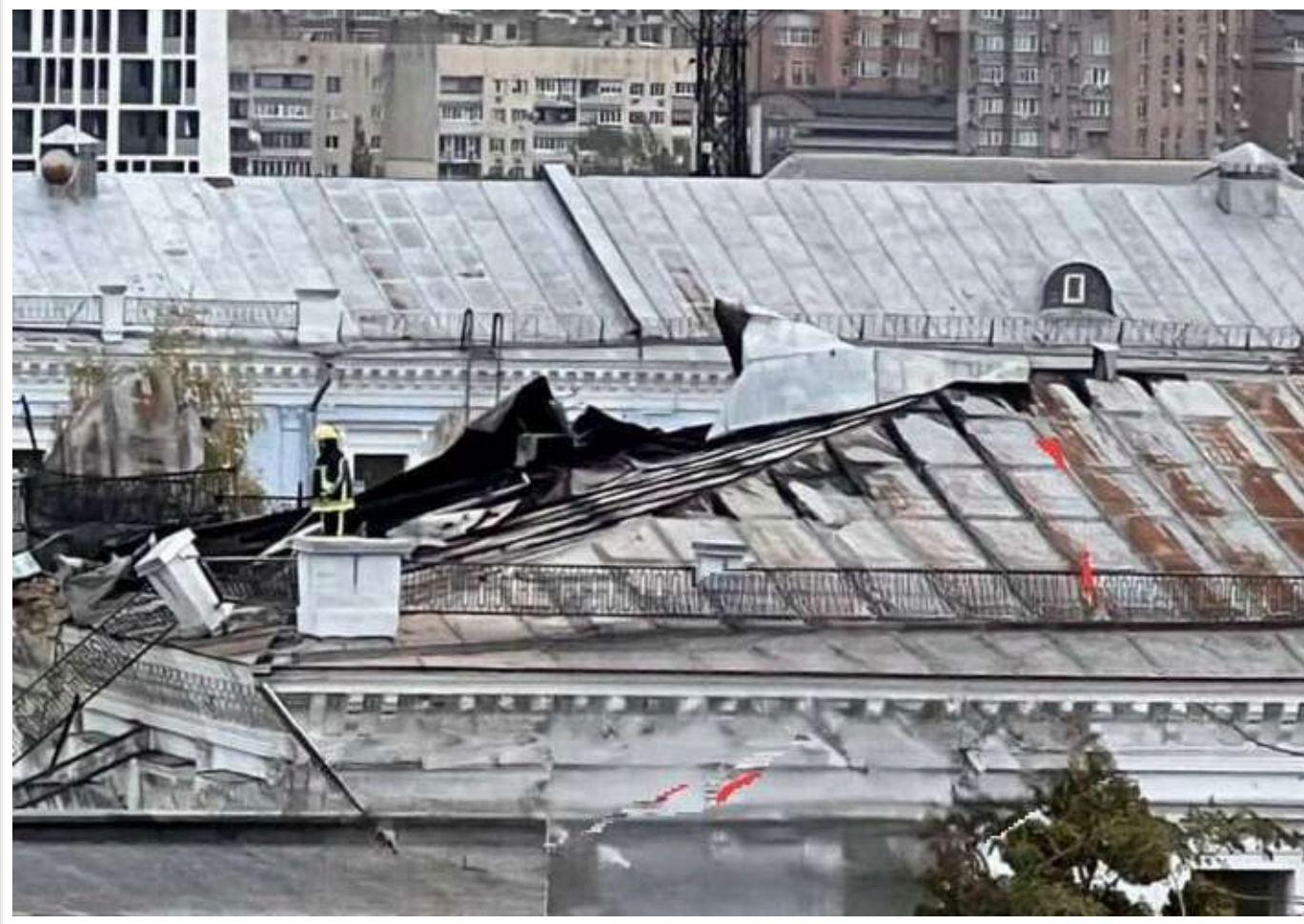
Внаслідок атаки БПЛА в Києві пошкоджена одна з будівель Генштабу ЗСУ
