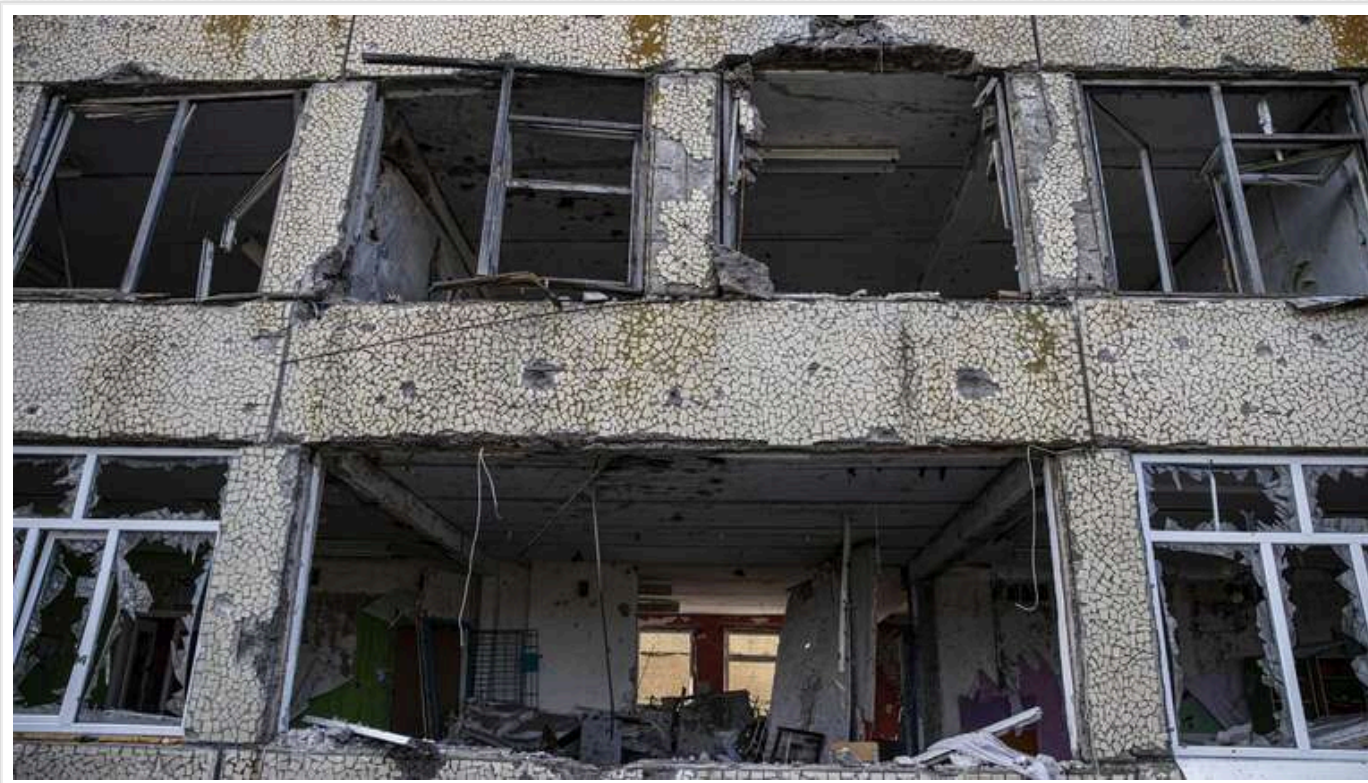
У Херсоні через обстріли частина міста залишилася без світла
