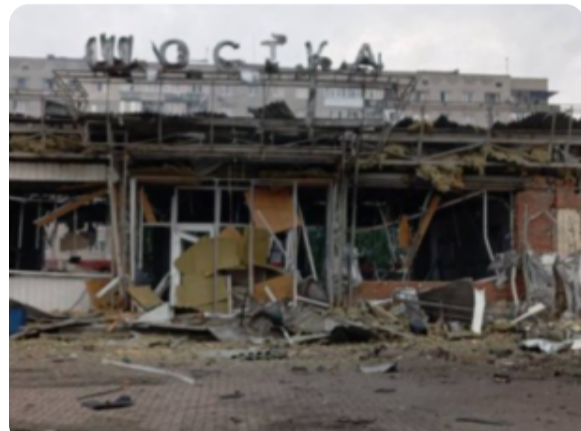
09:02 30.05.2026 РФ десятками дронів знищило будівлю вокзалу у Шостці – Центр журналістських розслідувань
