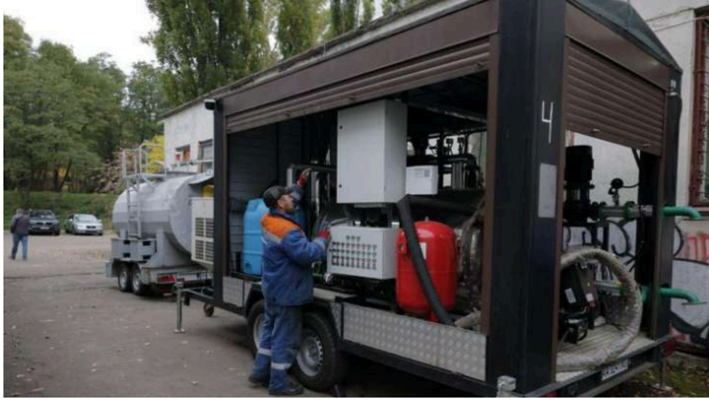
Фото: Мобільна котельня
