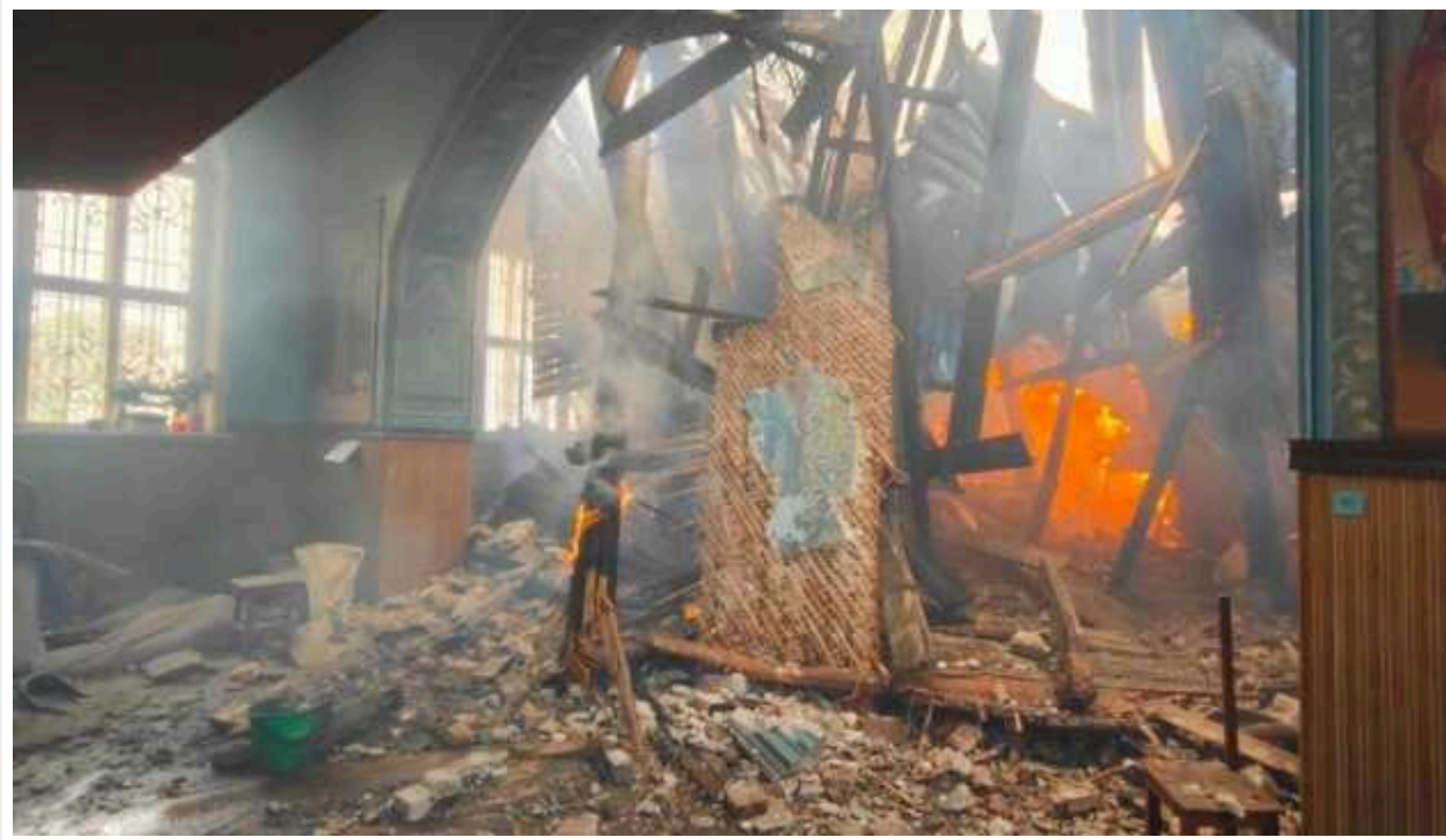
У Нікополі внаслідок російського обстрілу пошкоджена церква
