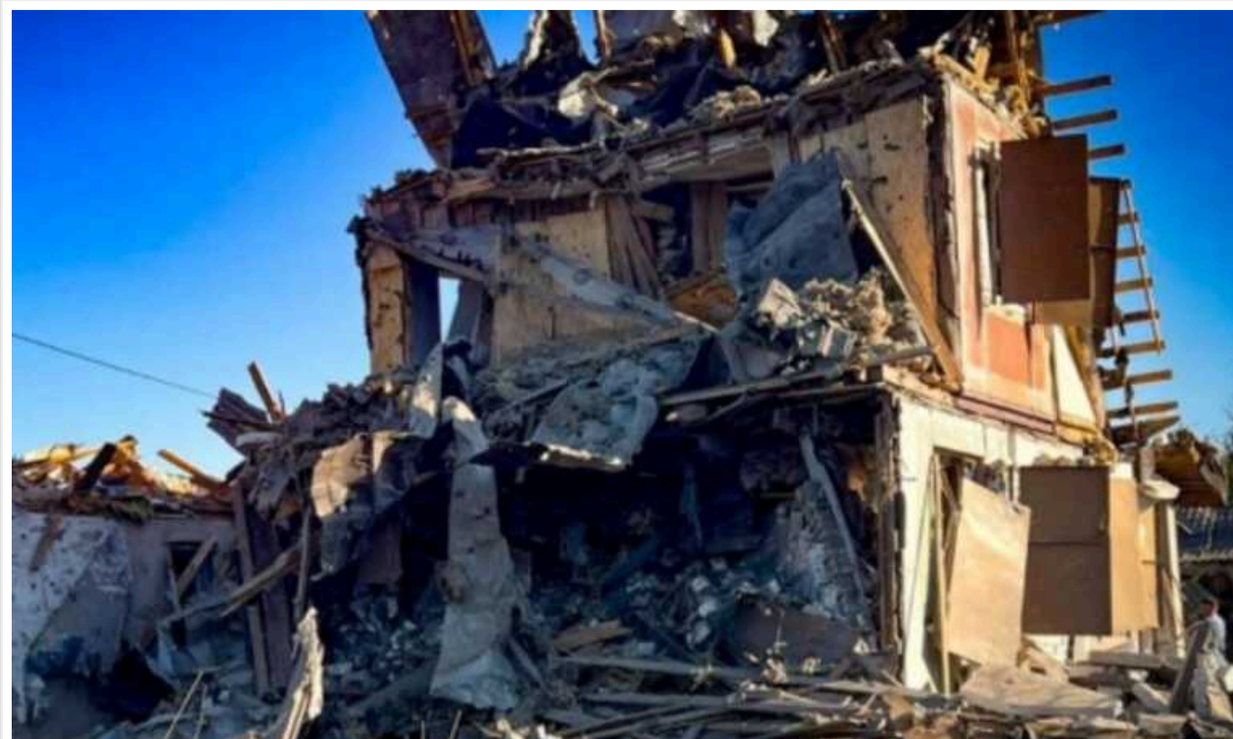
На Київщині внаслідок ранкової ракетної атаки пошкоджені 50 будинків, два з них зруйновано
