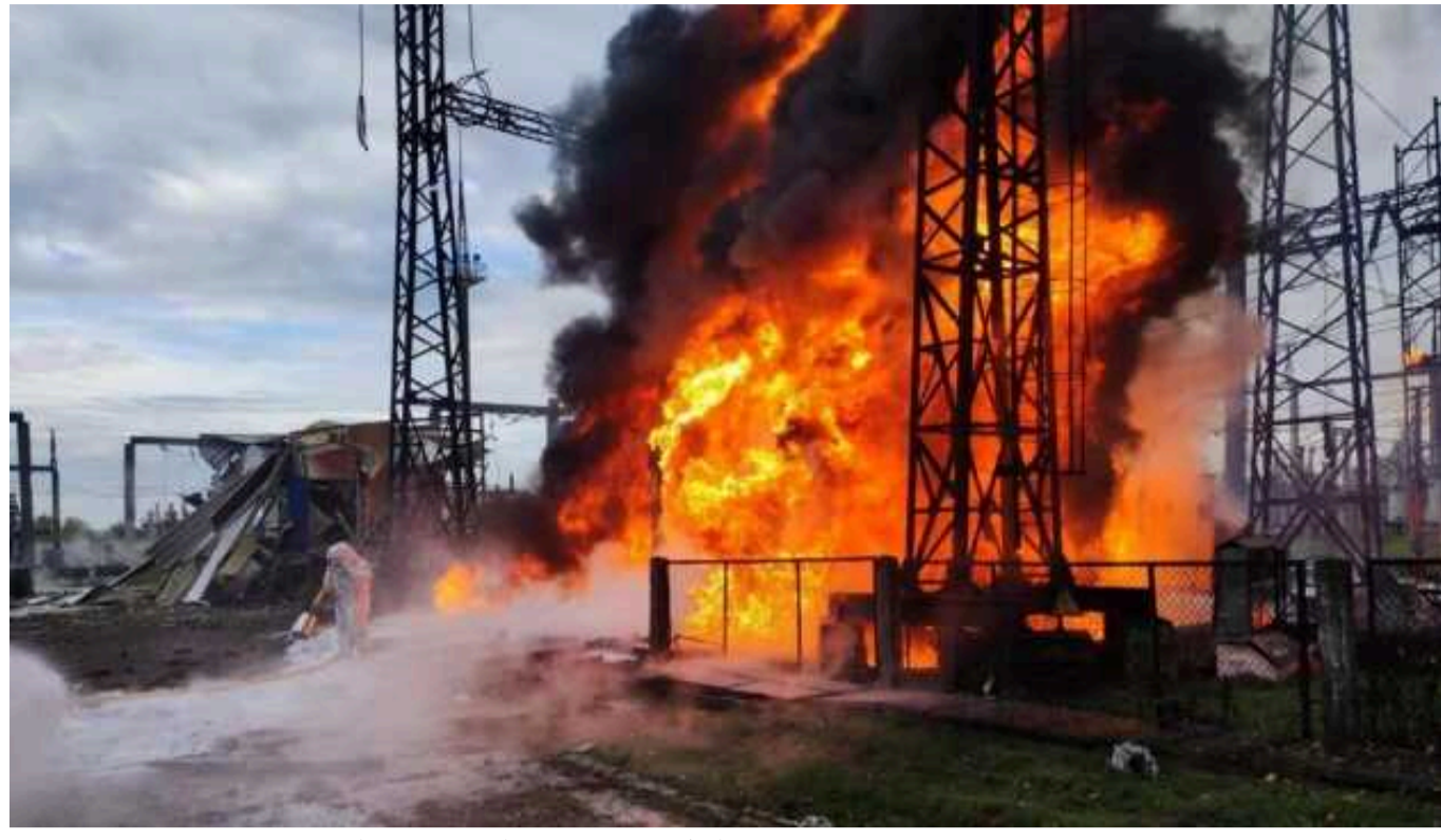
У Херсоні через атаку ворожих дронів пошкоджене електрообладнання, яке поки неможливо замінити
