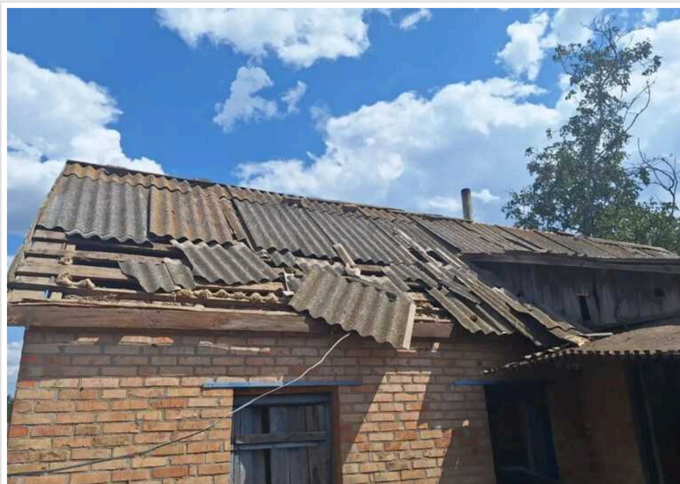
Окупанти знову обстріляли Нікопольщину: є поранені і руйнування
