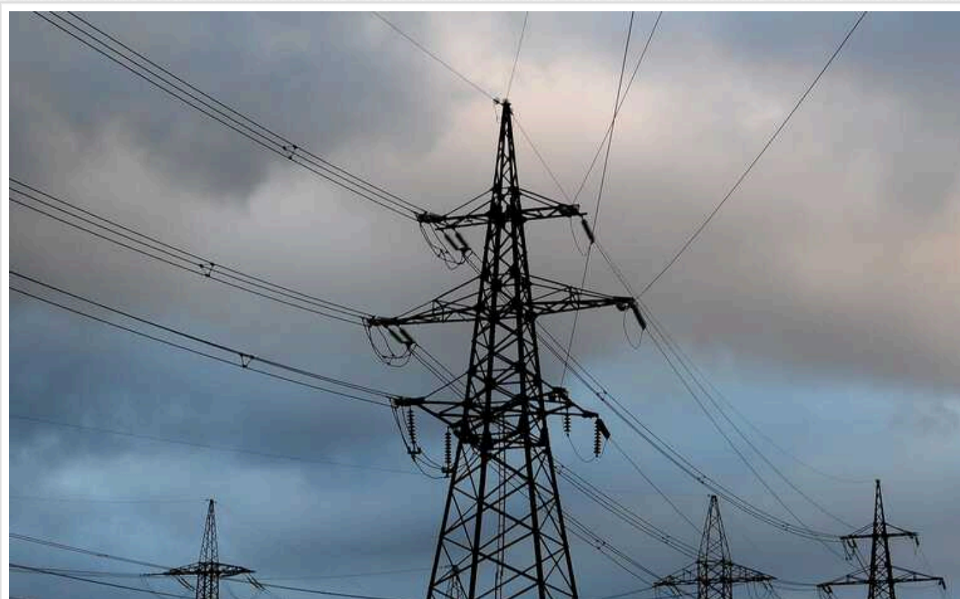
На Дніпропетровщині вночі був приліт по об'єкту енергетики, – Міненерго
