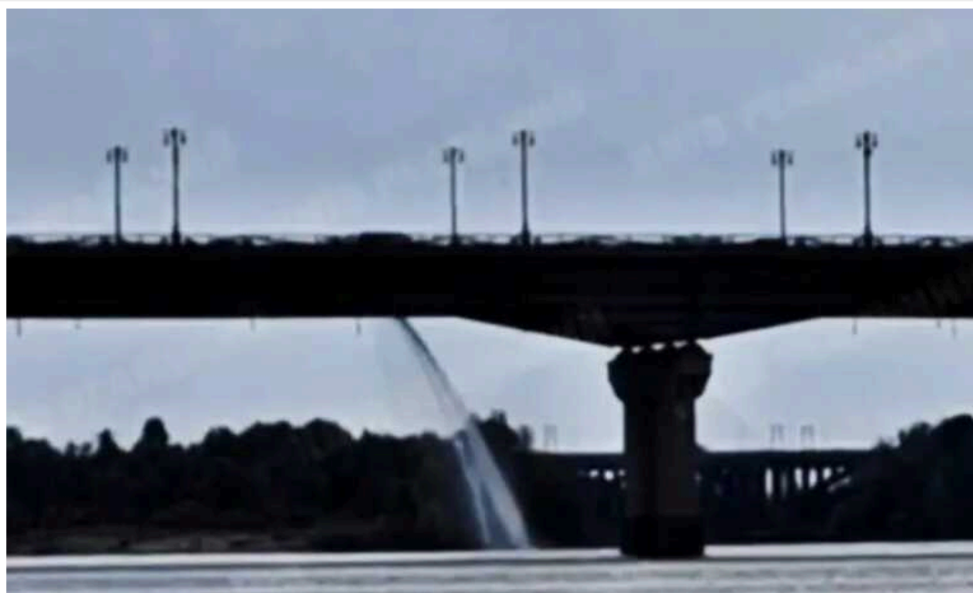
У Києві під мостом Патона після дощу утворився "водоспад"
