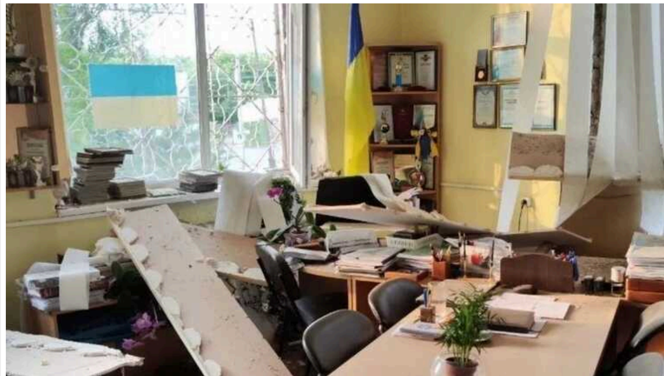
Унаслідок ворожої атаки по Дніпру пошкоджено приміщення школи
