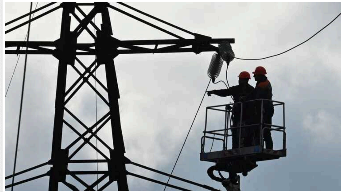
У середу відключення електроенергії не прогнозуються, - "Укренерго"
