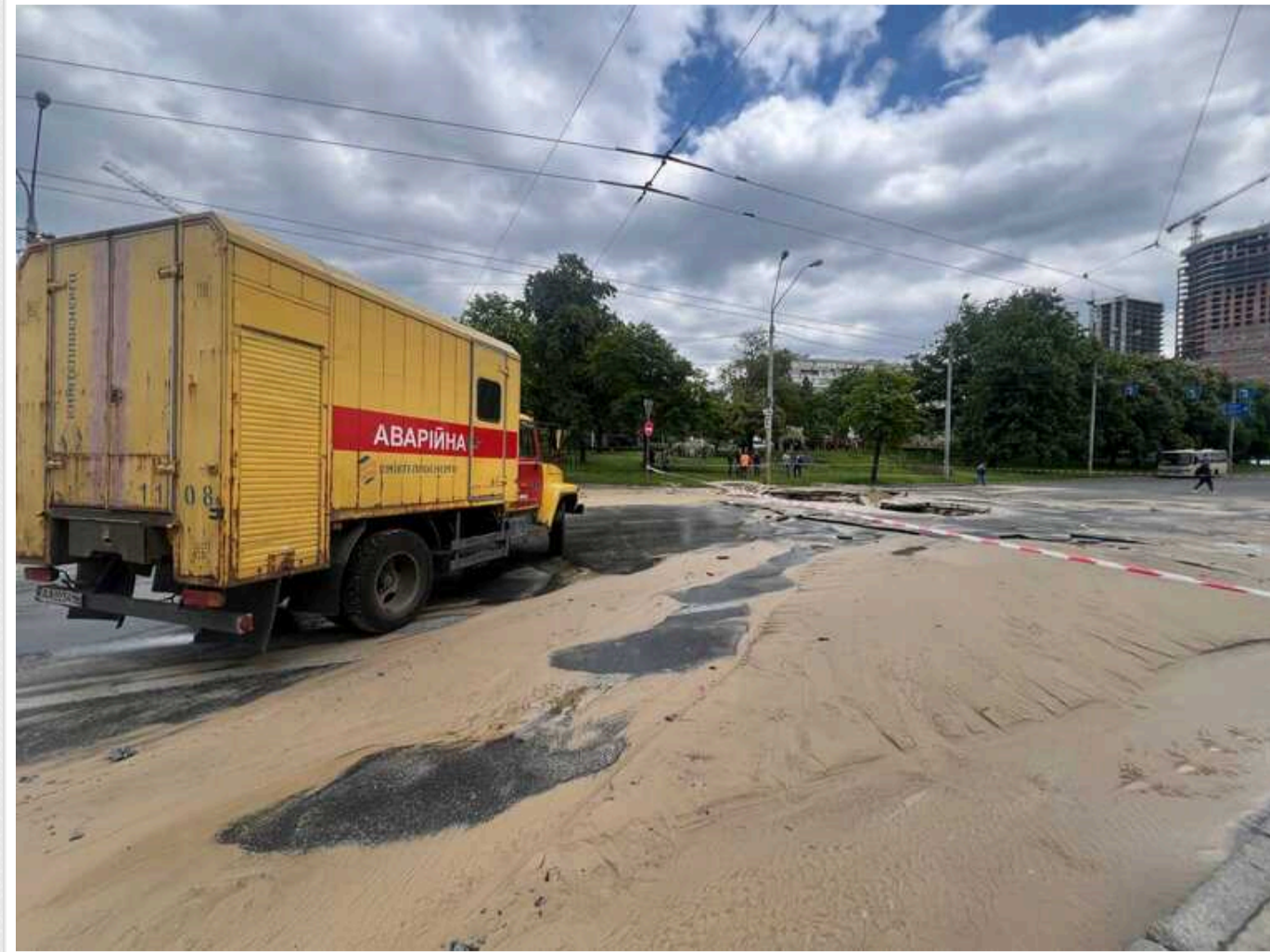
У Києві локалізували місце пошкодження трубопроводу на Либідській
