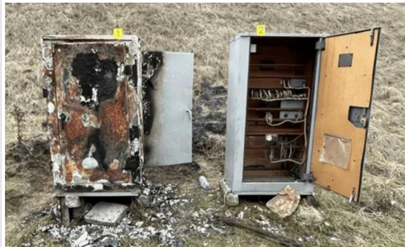
На Черкащині здійснено диверсію: підпалили релейну шафу на залізниці
