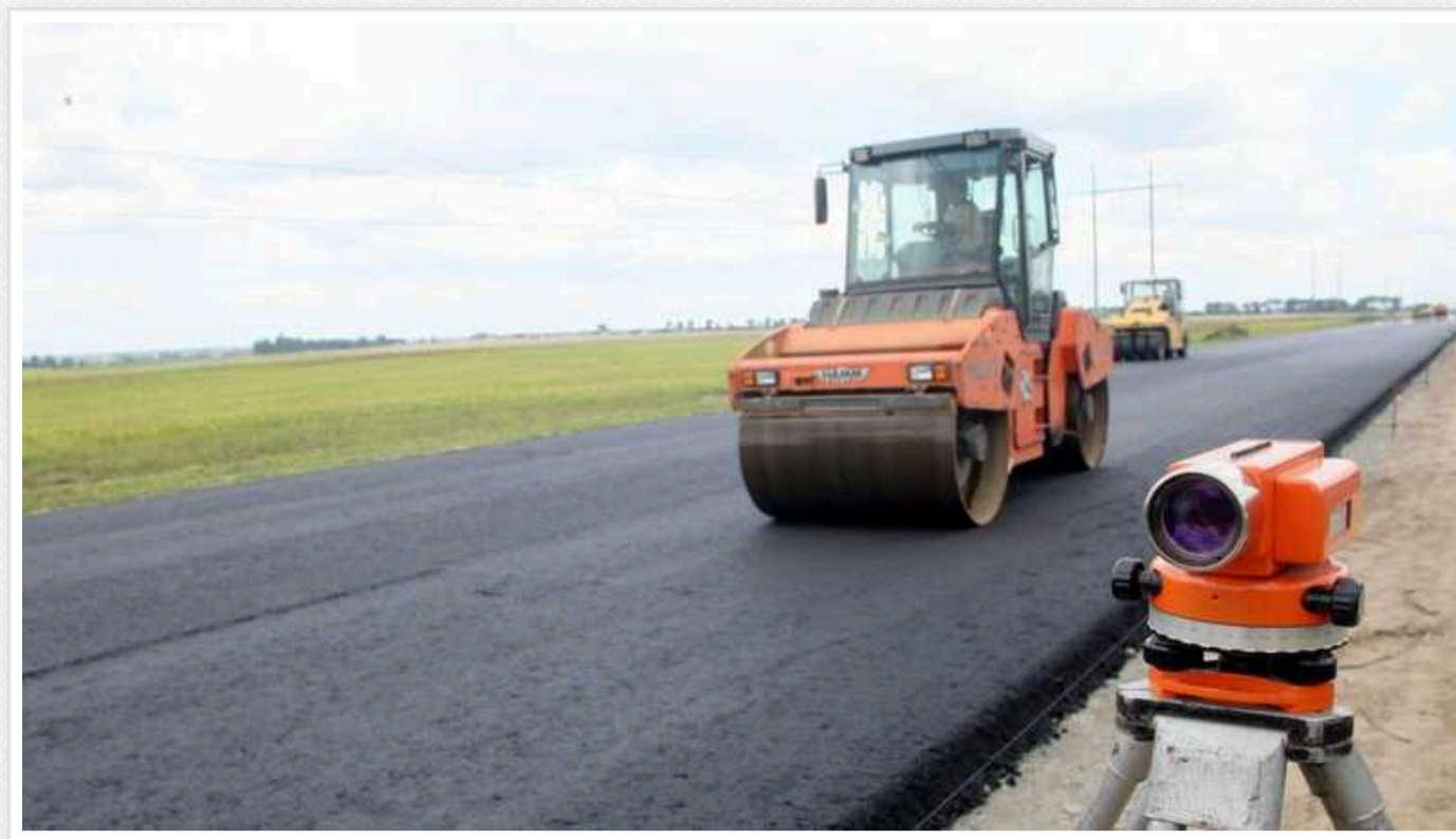
Ремонт доріг у прифронтових містах: тендер у Константинівці, у 2023 році будували від Вовчанська до Харкова
