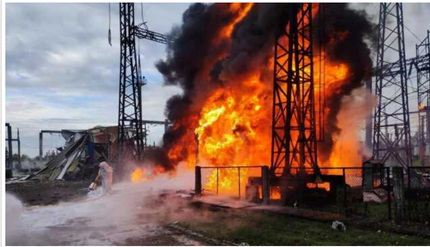
На Дніпропетровщині внаслідок атаки БПЛА пошкоджений об'єкт критичної інфраструктури
