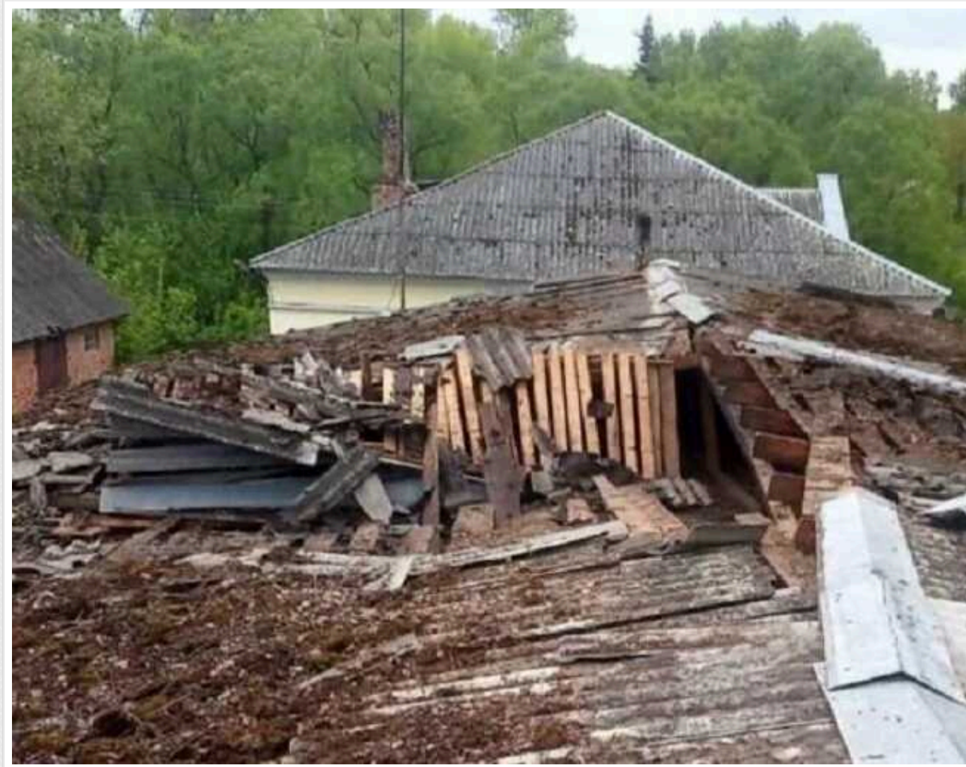
На Чернігівщині внаслідок ворожої атаки пошкоджено приміщення пожежної частини
