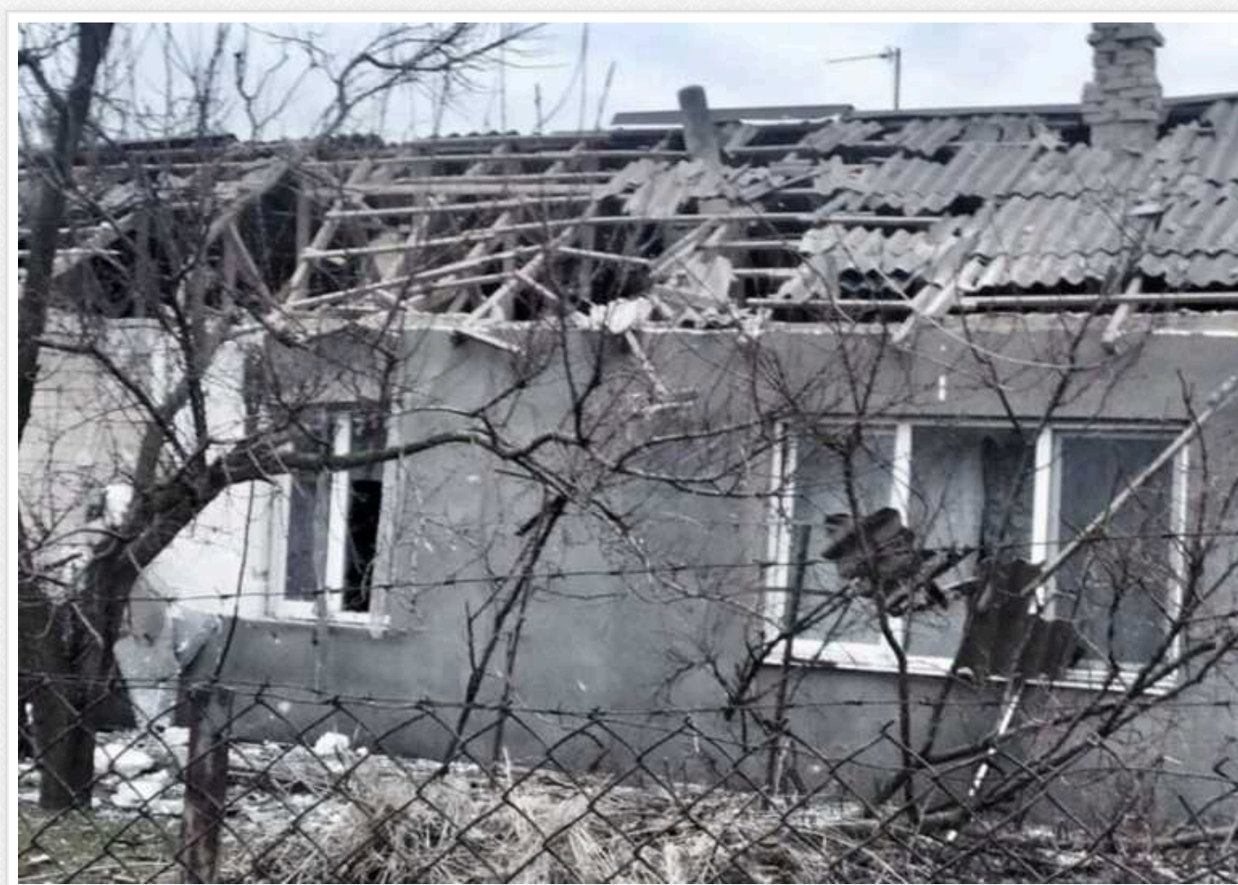
На Херсонщині внаслідок обстрілів пошкоджено приватні будинки, є постраждалі
