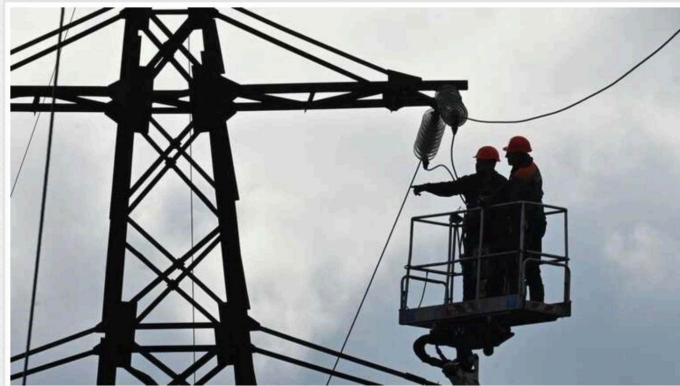
Вночі окупанти вдарили по прифронтовій ТЕС: пошкоджено обладнання
