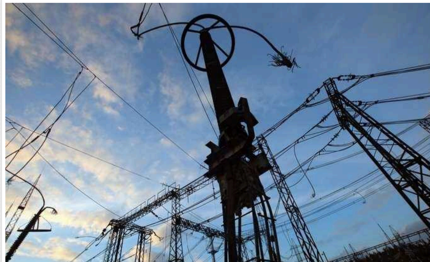
Наслідки атаки на Дніпропетровщину: без світла залишилося 29 тисяч абонентів
