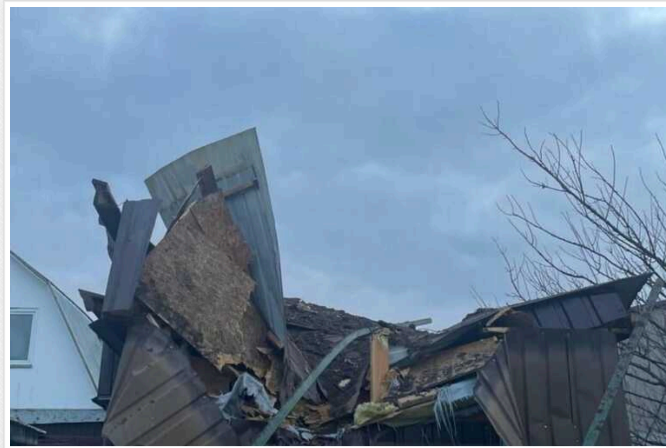
Наслідки ракетної атаки на Київщину 7 лютого: пошкоджено житлові будинки, є постраждалі
