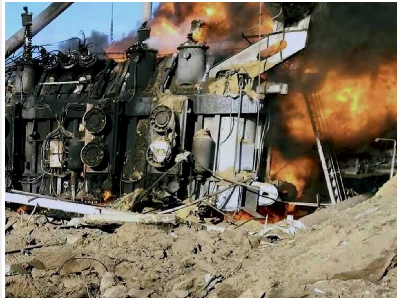
У Кривому Розі повністю відновили світло в усіх споживачів після "прильоту" до підстанції, - Міненерго
