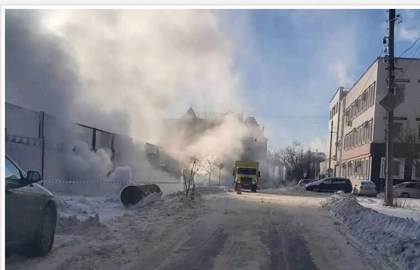
У російському Липецьку прорвало тепломережу: без опалення залишилося понад 70 багатоквартирних будинків
