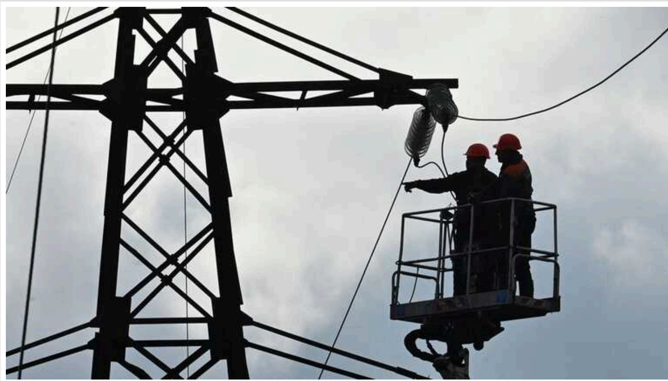
У Черкаській області уламки "Шахедів" пошкодили лінії електропередач: кілька населених пунктів без світла
