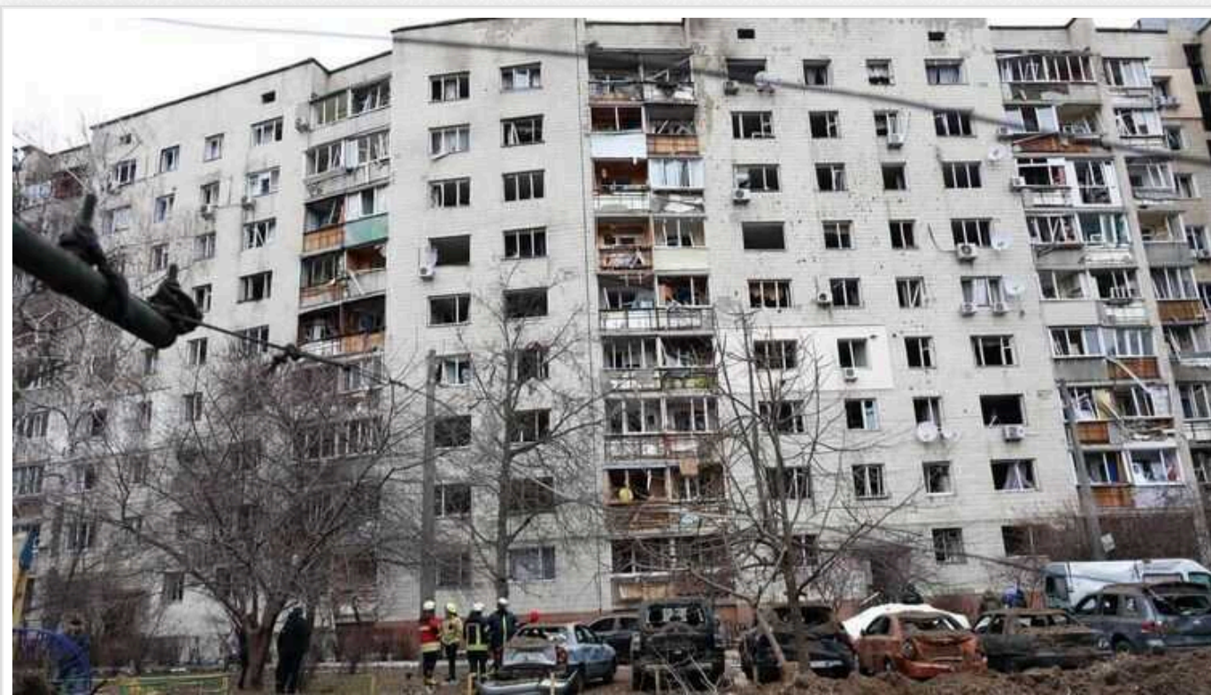
На Київщині уламками ракет пошкоджено 11 багатоквартирних будинків
