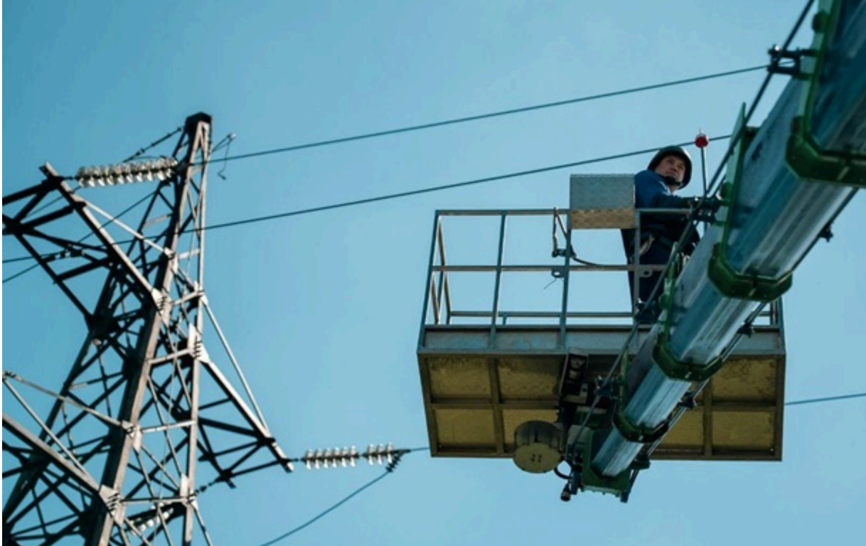
Фото: Тривіна/Суми. В енергетиків додалося роботи через нові обстріли і негоду
