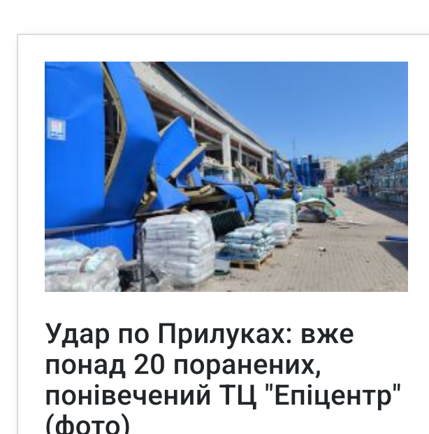
Удар по Прилуках: вже понад 20 поранених, повнечений ТЦ "Епіцентр" (фото)
