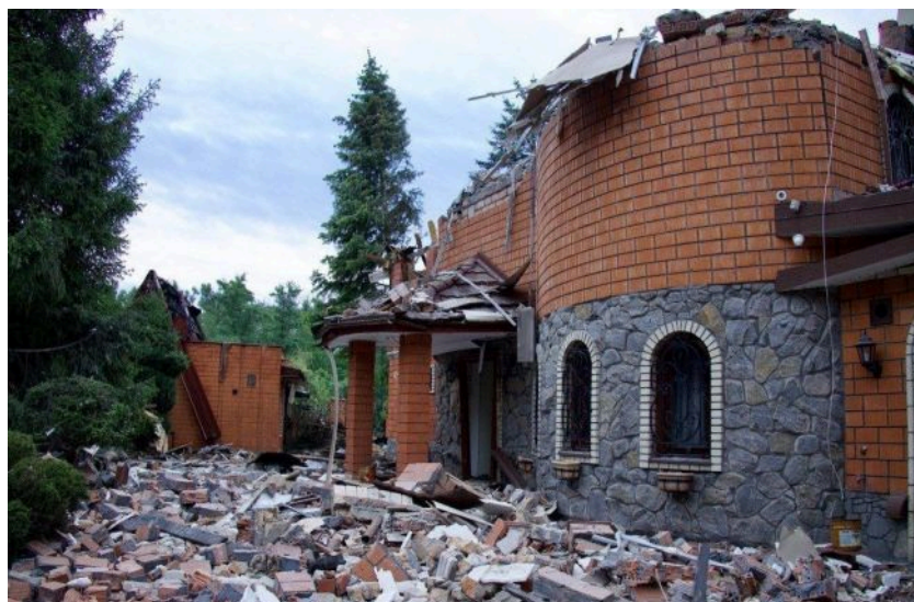
Фото: пошкоджена будівля у Дніпрі (t.me/dnipropetrovskaODA)
