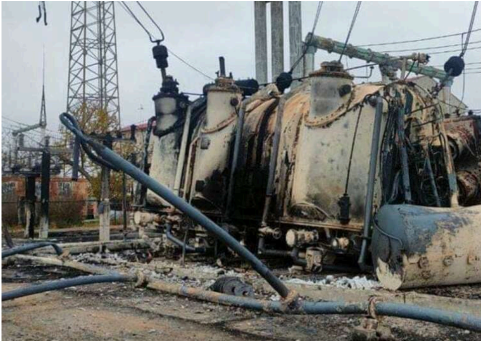
Енергетичний щит на 24 мільярди: Кабмін масово замовляє захист підстанцій та трансформаторів за кошти з Резервного фонду
