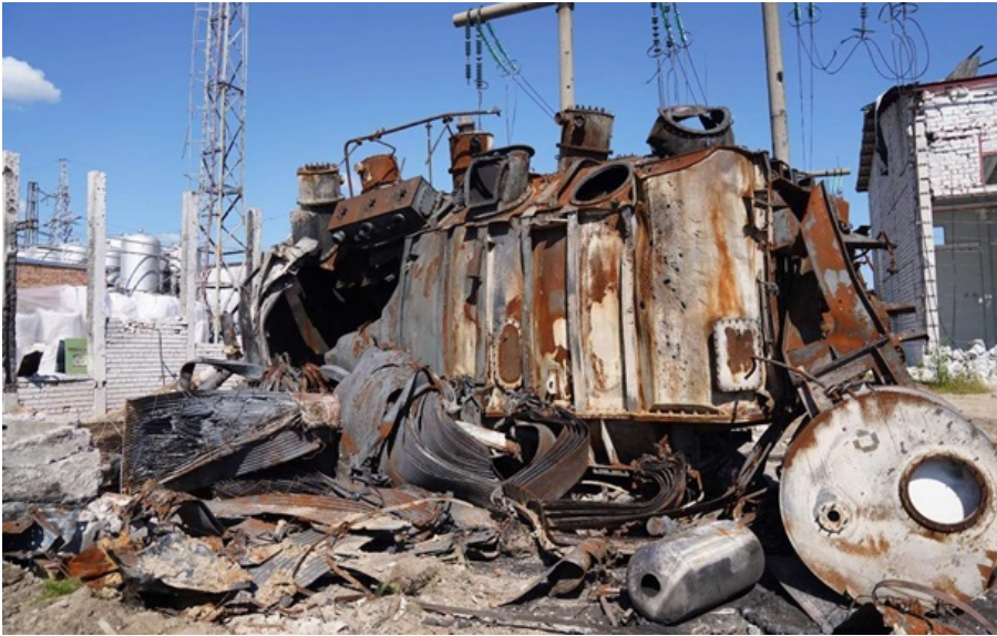
Фото: Укренерго Пошкоджений енергетичний об'єкт (архівне фото)
