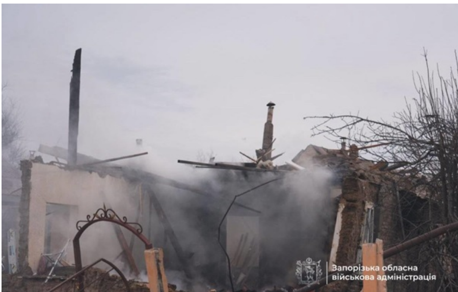
Фото: Запорізька ОВА Разрушенный дом в Запорожье
