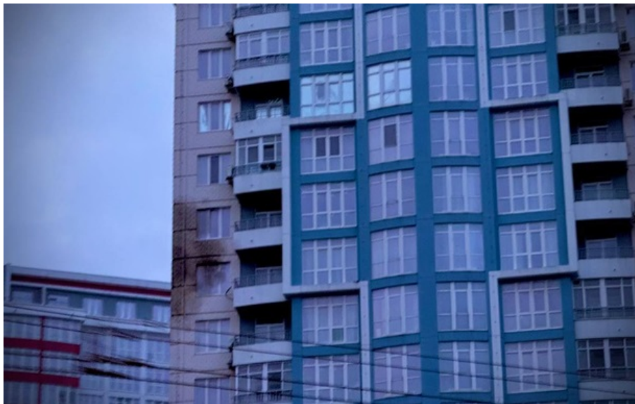
Фото: Сергій Лисак/Telegram Жилой 22-этажный дом в Одессе получил повреждения
