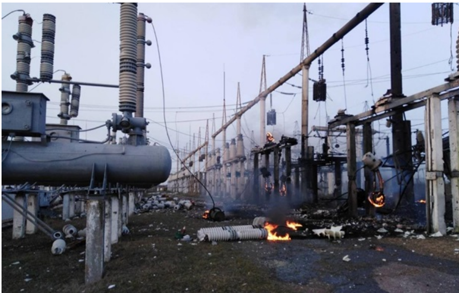
Фото: Укренерго Пошкоджений енергетичний об'єкт (архівне фото)
