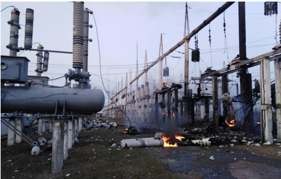
Фото: Укренерго Пошкоджений енергетичний об'єкт (архівне фото)
